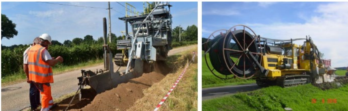
Exemple de trancheuse en action (Source : Le Journal de Saône et Loire ; Tattu TP)
